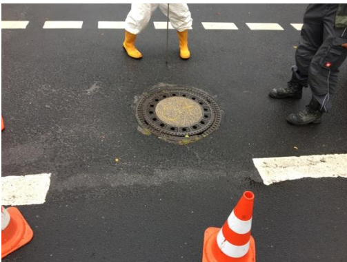
Schacht in Straßenkörper
